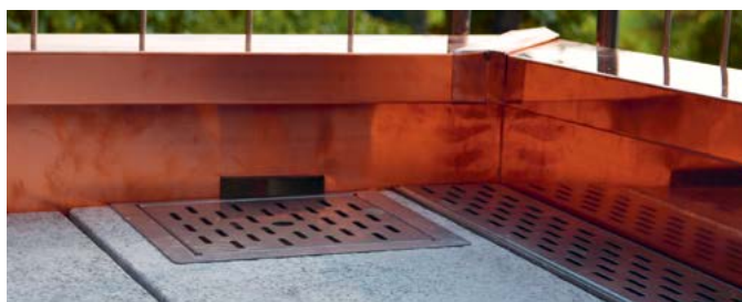
Fig. 32: Troppopieno con griglia forata e canaletto di drenaggio (dalla guida alla norma SIA 271).
